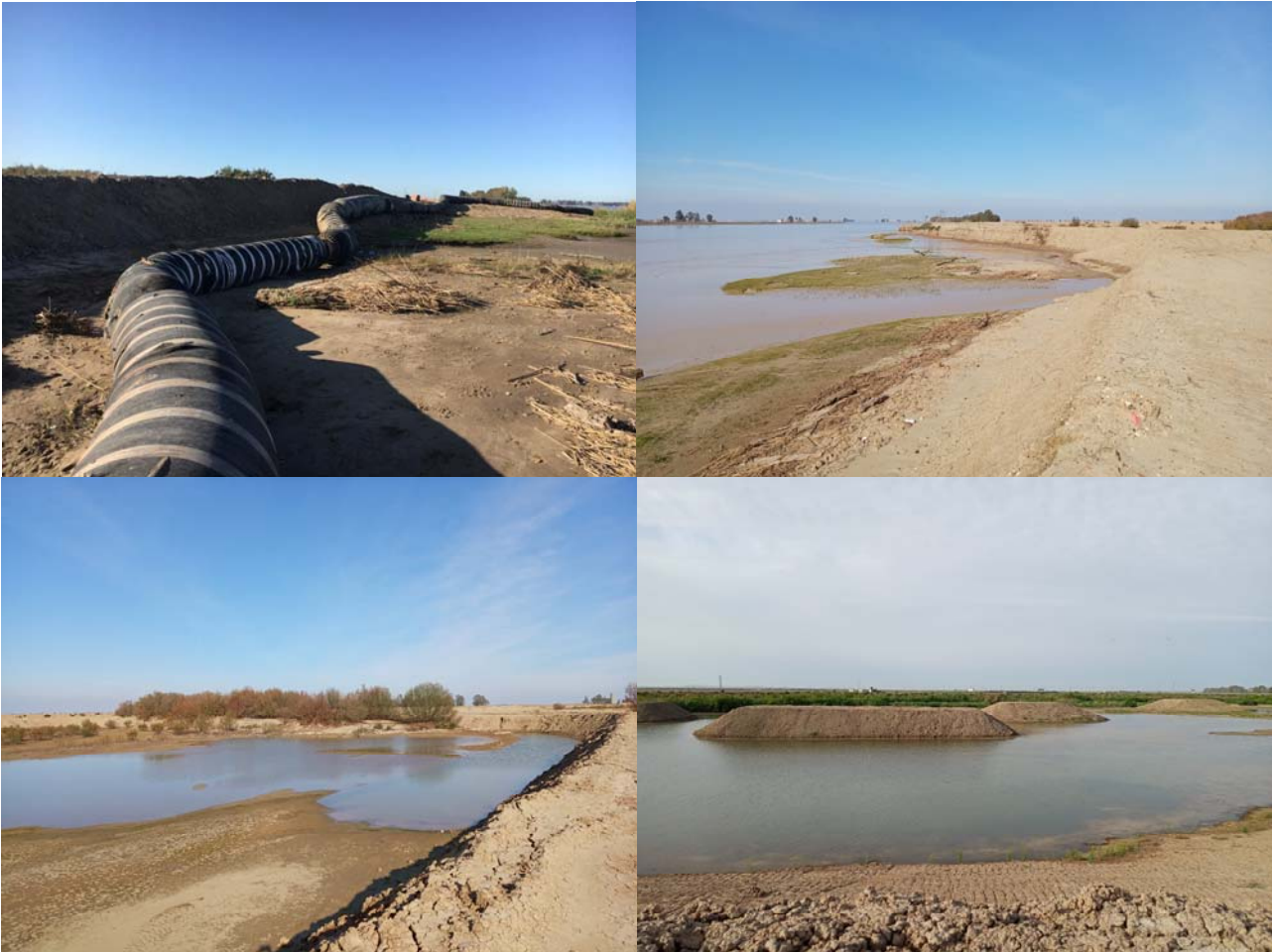
Fotografía 7. Conducción de vertido sobre el borde oeste de Horcada2 a mediados de septiembre de 2019 (arriba izquierda); panorámica de la orilla del río Guadalquivir y lado oeste de Horcada2 con marea alta a mediados de febrero de 2020 (arriba derecha); lámina de agua residual en subsector norte de Horcada2 procedente del vertido destinado a Horcada1 a mediados de febrero de 2020 (abajo izquierda); estado post-vertido de las islas artificiales en Horcada1, con una gran diferencia entre la cota de coronación y la superficie del agua debido al bajo nivel de inundación (abajo derecha) (Autor: R.Muriel, EBD-CSIC).
