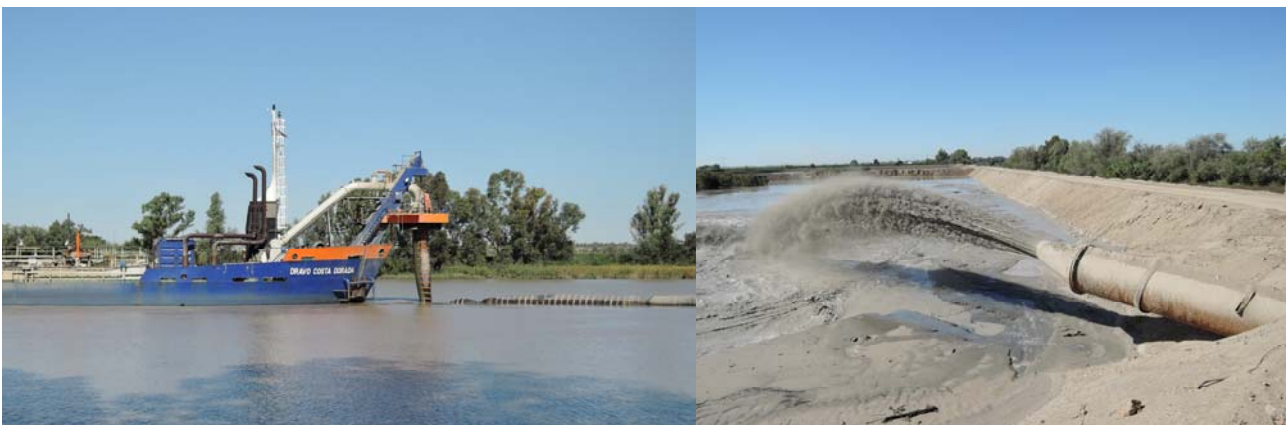
Fotografía 4. Descarga desde la draga de materiales dragados del fondo del río Guadalquivir a través de la conducción de vertido (izquierda) e impulsión en el sector de Butano3S (derecha) a principios del mes de octubre de 2019 (Autor: R. Muriel, EBD-CSIC)..
