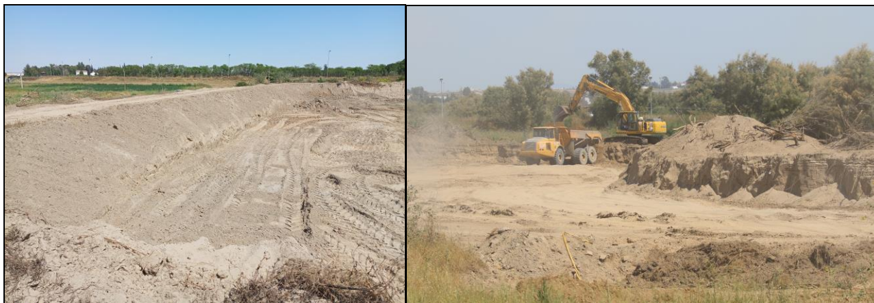
Fotografía 51. Extracción de materiales y remodelación completa de la mota perimetral en el lado NE (izquierda), y extracción de materiales en curso en el frente de los acopios de materiales antiguos cubiertos por tarajal maduro (derecha), en el sector Butano1 desde el mes de mayo de 2020 (Autor: R. Muriel, EBD-CSIC).
