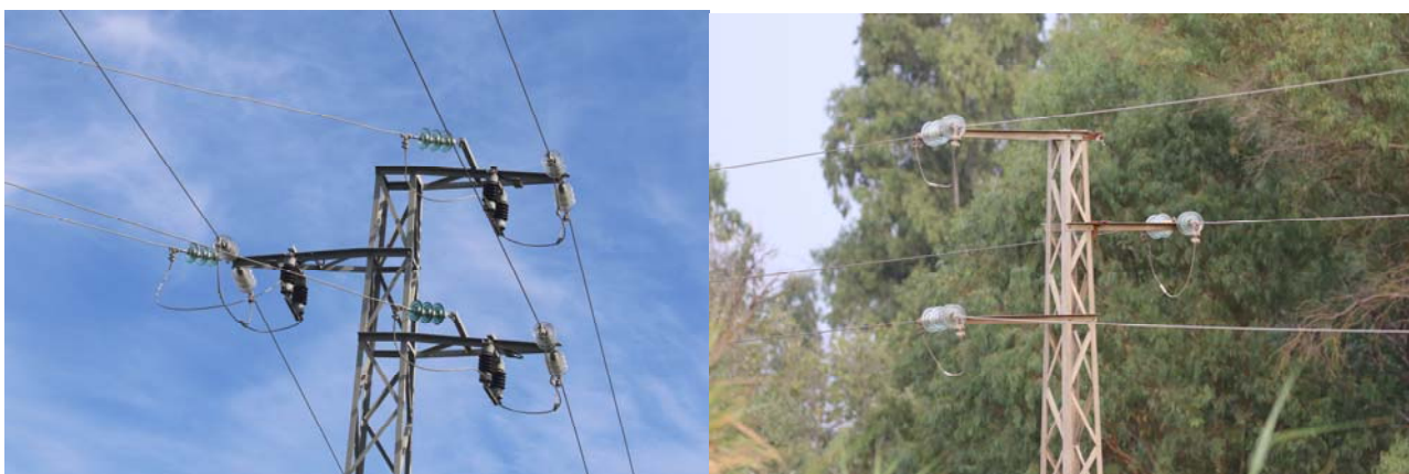
Fotografía 16. Ejemplos de diseños peligrosos de crucetas en apoyos del tramo de línea eléctrica de distribución existente en el vaciadero de Butano: tresbolillo amarre con derivación inferior y seccionadores (izquierda), y tresbolillo de amarre simple (derecha) (Autor: R. Muriel, EBD-CSIC).
