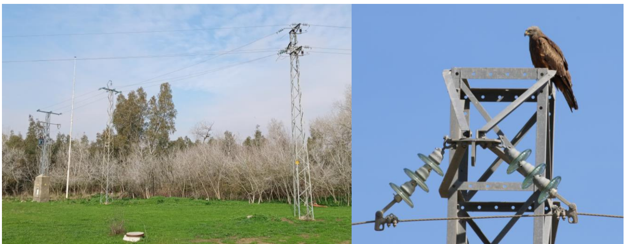
Fotografía 46. Tres de los apoyos más peligrosos del tendido eléctrico de distribución en Butano1, con diseño de amarre con o sin seccionadores o puentes por arriba (derecha). Milano negro ( Milvus migrans ) posado sobre apoyo tipo tresbolillo no peligroso en el entorno del río Guadalquivir a principios de marzo (derecha) (Autor: R. Muriel, EBD-CSIC).
